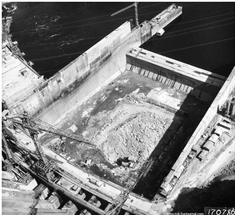
Рисунок 1. Разрушение дна водобойного колодца СШГЭС
