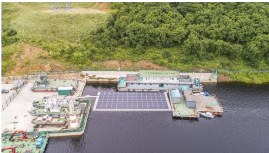
Рисунок 3. Солнечные панели, расположенные на Нижне-Бурейской ГЭС
