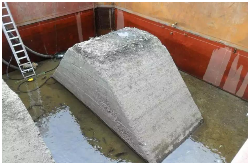
Рисунок 2. Кавитационное разрушение шашки Новосибирской ГЭС
