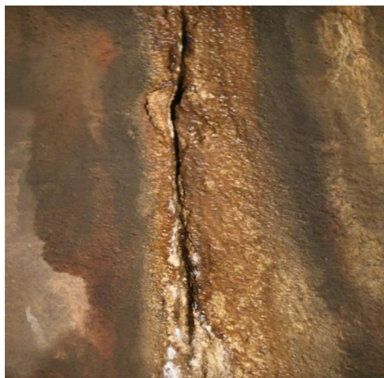
Рисунок 3. Раскрытие строительного шва
