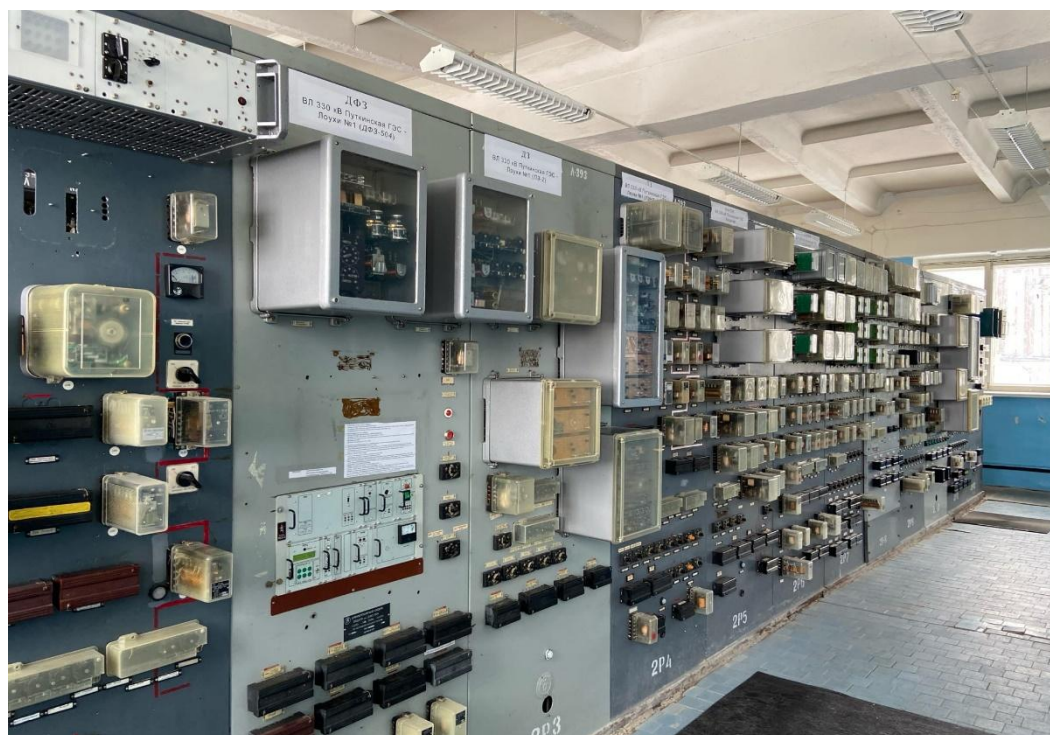
Рисунок 2. Оборудование комплектов РЗА ОПУ-330 кВ
